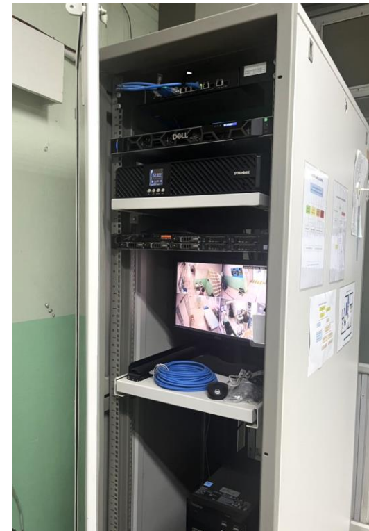
ตู้เก็บระบบ PACs
